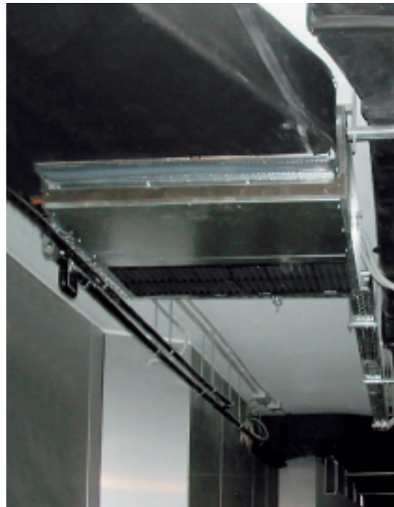
Una unità interna del sistema VRF installata a soffitto in prossimità di un condotto di distribuzione dell’aria primaria attraverso un diffusore di tipo lineare.
