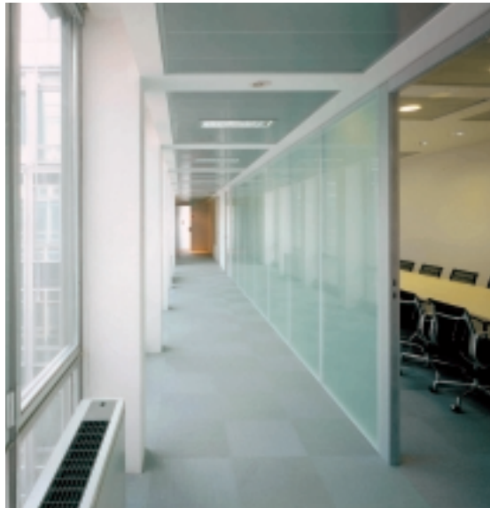
Un particolare dell'installazione di una unità interna verticale a mobiletto del sistema VRF adiacente a una superficie vetrata.
