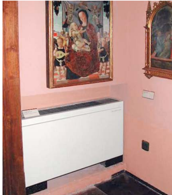
Un particolare di installazione di una unità interna verticale a mobiletto in una rientranza ricavata nella parete di una delle sale, che si armonizza con l'ambiente.
