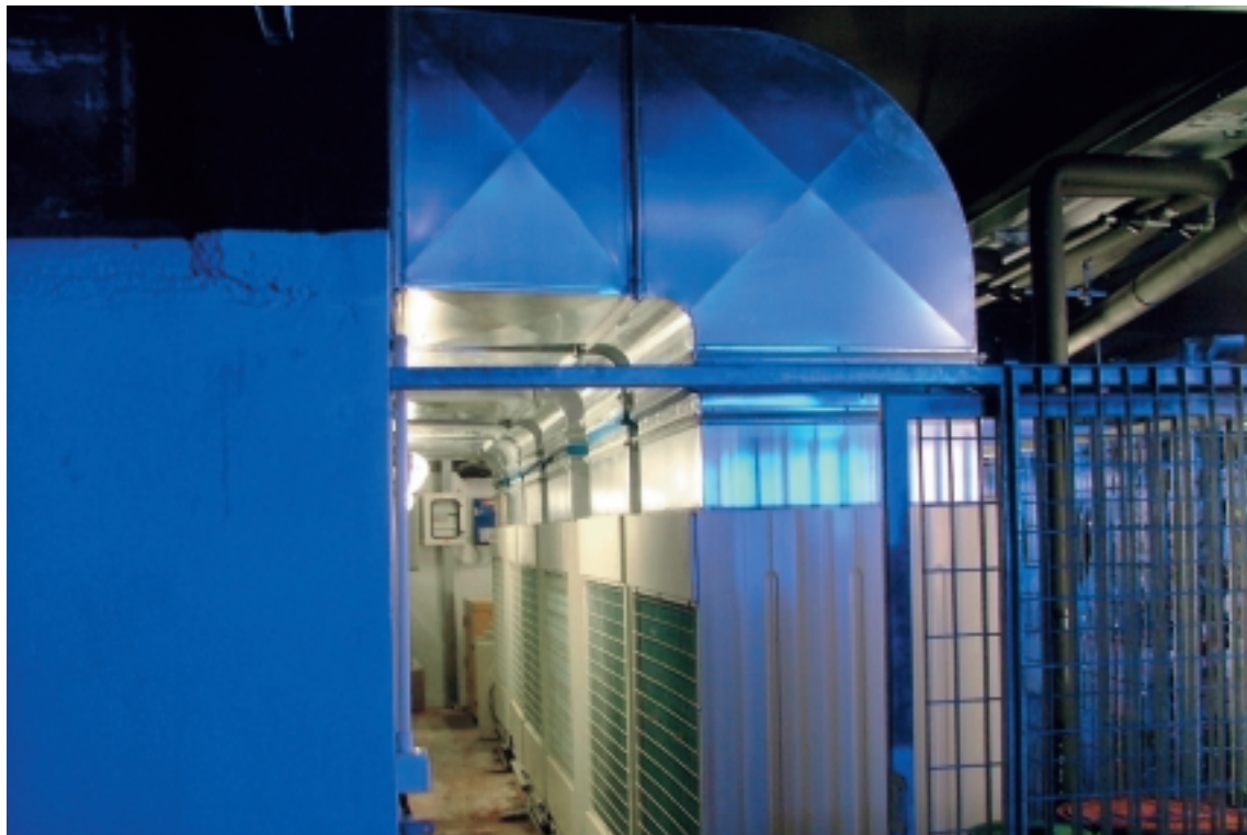
Alcune delle unità esterne del sistema VRF installate all'interno delle quali sono stati canalizzati gli scarichi dell'aria (Mitsubishi Electric)
